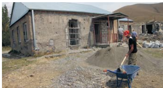
Het opknappen van de school in Tretuk was vorig jaar september al een eind gevorderd.
