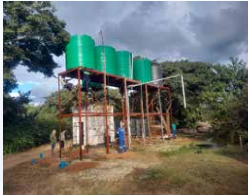
Met dank aan de zonnepanelen en de opvangtanks komt er nu altijd water uit de kraan.
